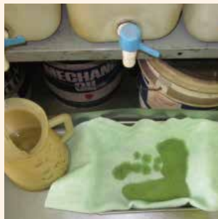
オイルタンク油漏れ除去として
